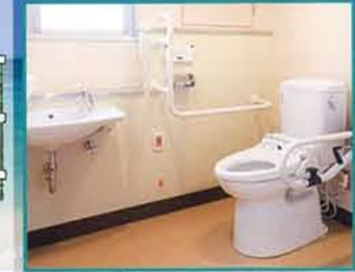
身障者用WC完備
